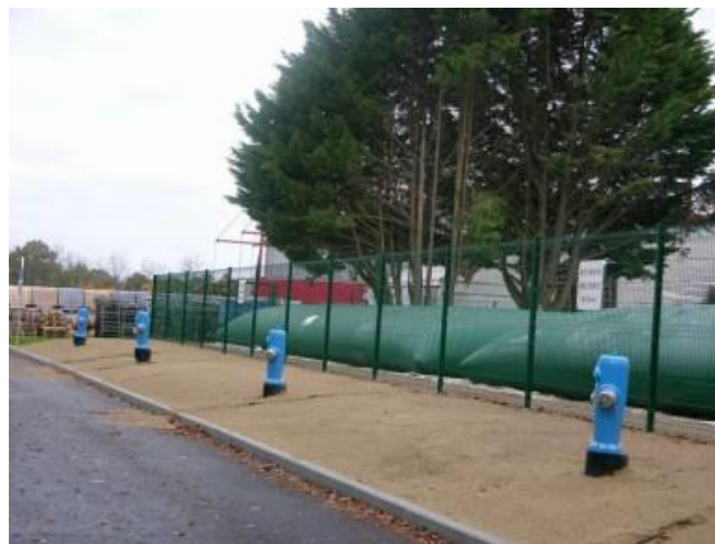
Piquage enterré et poteaux d'aspiration DN 150
